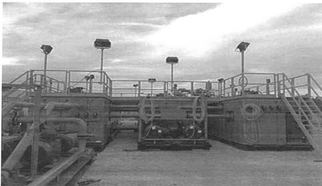
Sistemul de depozitare a fluidului de foraj la sonda
