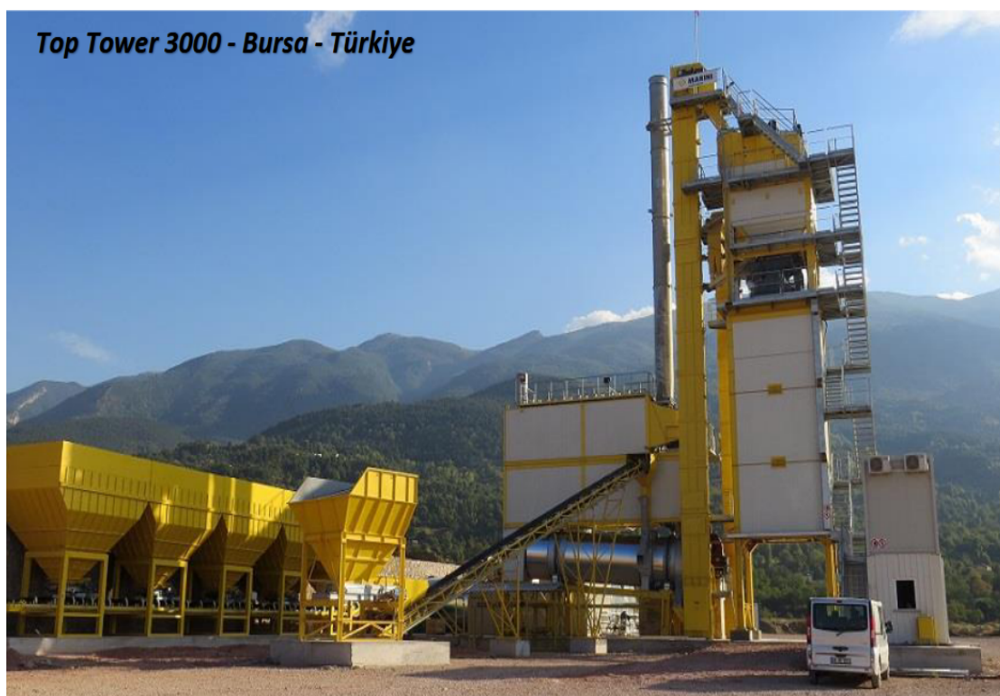
Figura nr. 4 – stație de mixturi asfaltice
